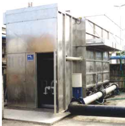
Flottatore lamellare ad aria dissolta con capacità di trattamento pari a 220.000 l/h, installato presso un impianto Consortile.
