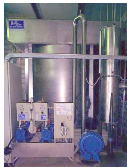
Flotto-filtro ad aria dissolta con capacità di trattamento pari a 40.000 l/h progettato e realizzato dalla Bio Mass Impianti S.r.l. per il recupero tecnologico delle acque reflue da industria alimentare, a valle di trattamento biologico.
