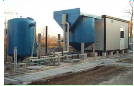
Flottatore ad aria dissolta con capacità di trattamento pari a 30.000 l/h e box impianti indipendente accorpante tutte le macchine di servizio, nel trattamento di reflui da Lavanderia Industriale.
